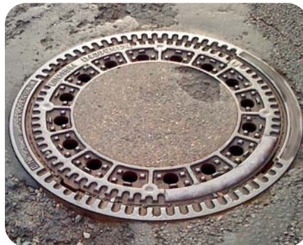
Frostschäden an Straße und Abdeckung
