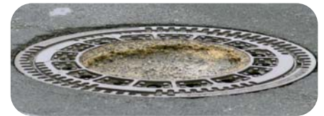
Abgeplatzter Beton an Schachtabdeckung
