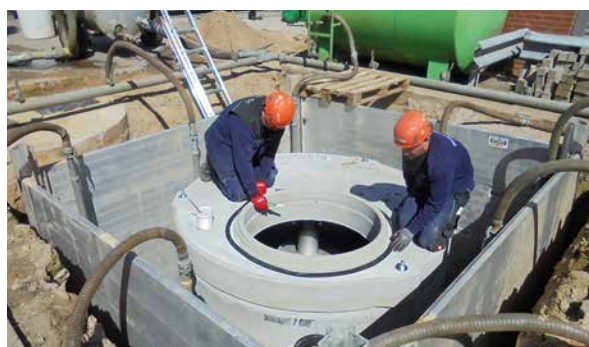
Gerade auch für den Schachtaufbau bis zur Oberkante gelten strenge Anforderungen an die Dichtheit
