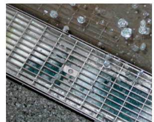
Wasserpegel bis Unterseite Abdeckrost
