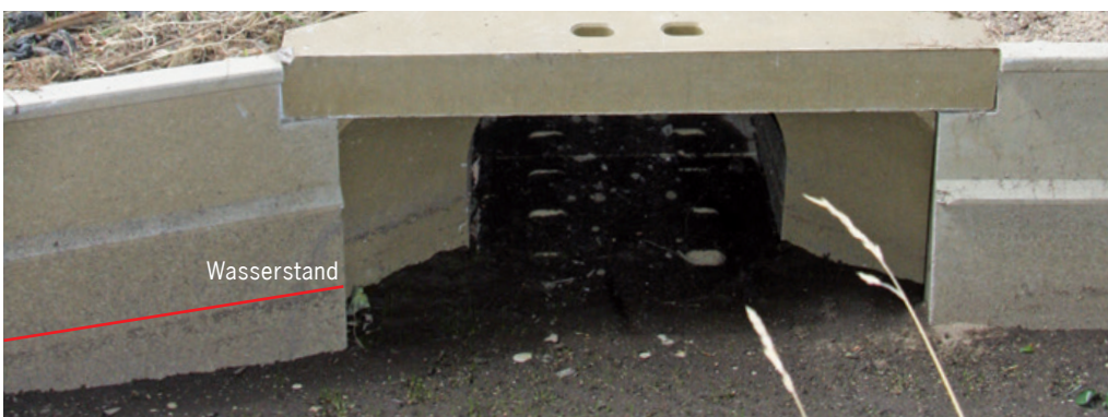
Klimasohlplatten mit Drainagefunktion nach einem Starkregenereignis
