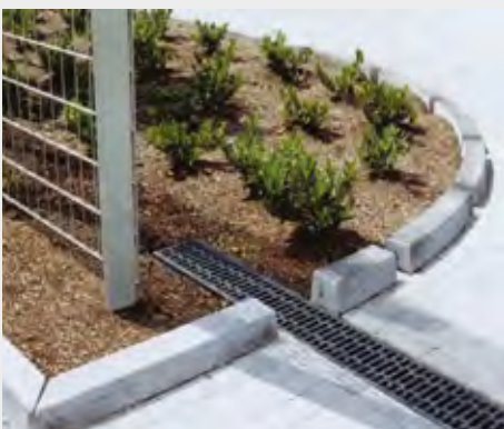
Entwässerungsrinnen nehmen das anfallende Niederschlagswasser sicher auf und leiten es oberflächennah in die angrenzende Grünfläche. Dort kann es nach und nach versickern – und die Bepflanzung wird gezielt bewässert
