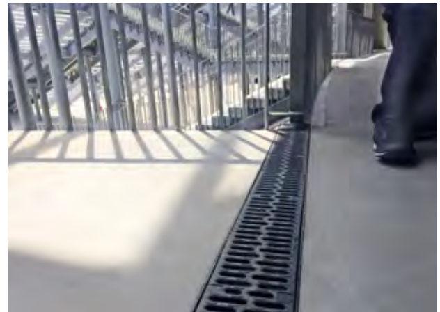
ACO DRAIN® Civicline im Umlauf des Stadions
