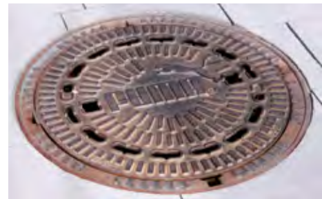
Schachtabdeckung mit Firmenlogo
