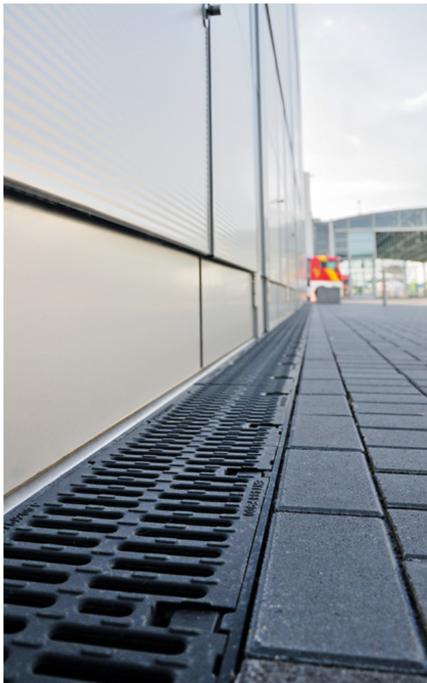
ACO PowerDrain im Außenbereich der Messe Hannover
