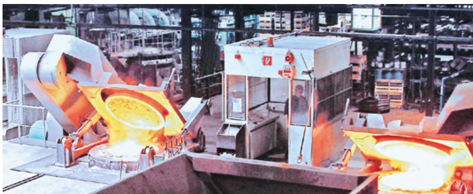
Moderne Mittelfrequenz-Induktions-Schmelzöfen, ACO Kaiserslautern
