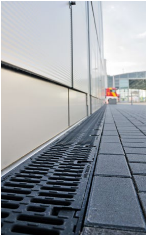
ACO PowerDrain im Außenbereich der Messe Hannover
