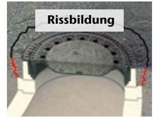
Durch Schwingungen erzeugte Risse an herkömmlichen Schachtabdeckungen
