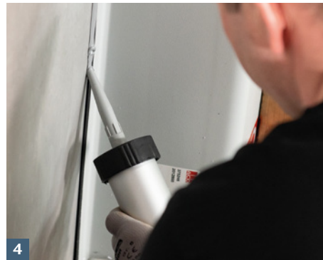
4 ACO Therm® Block umlaufend mit Aqua Blocker aus Kartusche abdichten.
