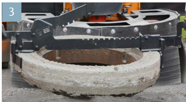
Schadhafte Abdeckung ausheben
